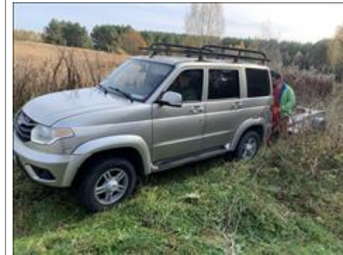
Установка столбов для туристской марки Для доставки асбоцементных столбов к месту установки используются автомобили повышенной проходимости и бортовые прицепы. 01-06.10.2020
