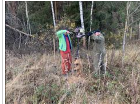
Установка столбов для туристской марки Установка асбоцементных столбов начинается с бурения скважины. 01-06.10.2020
