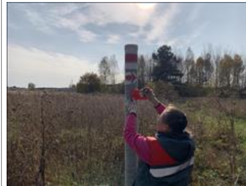
Установка столбов для туристской марки Установка асбоцементных столбов и нанесение на них туристской марки. 01-06.10.2020
