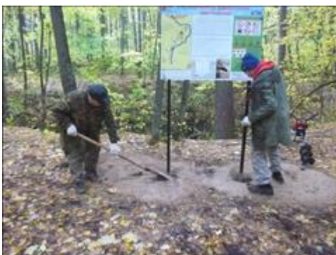
Установка информационных стендов и указателей Монтаж информационного стенда на водном маршруте по р. Пьяна, Ичалковский заказник, Старцев провал 25.09.2018
