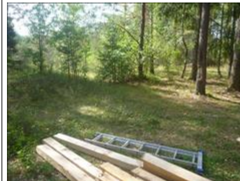
Тур стоянка "Убежицкий карьер" Возведение тур стоянки "Убежицкий карьер" недалеко от д. Убежицы 56° 4'22.95"С 43°20'16.00"В начало работ 22.06.2018
