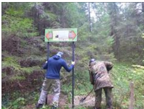
Установка информационных стендов и указателей Монтаж информационного указателя на пешеходном маршруте поворот на тур стоянку "Убежицкий карьер" 04.10.2018
