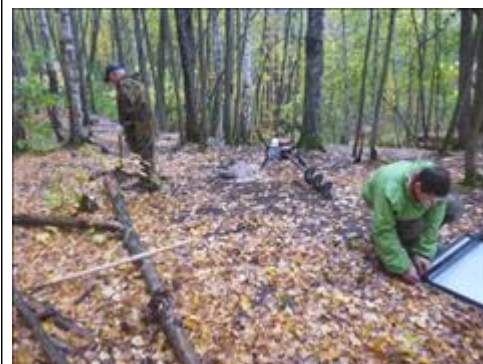
Установка информационных стендов и указателей Монтаж информационного стенда на водном маршруте по р. Пьяна, Ичалковский заказник, пещера Студенческая 25.09.2018
