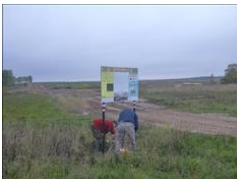
Установка информационных стендов и указателей Монтаж информационного стенда на пешеходном маршруте, д. Кудрешки 04.10.2018
