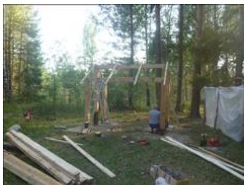
Тур стоянка "Убежицкий карьер" Возведение тур стоянки "Убежицкий карьер" недалеко от д. Убежицы 56° 4'22.95"С 43°20'16.00"В продолжение работ 22.06.2018
